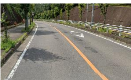
劣化の著しい三好丘中前の道路
