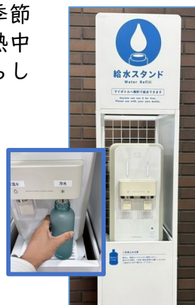
北庁舎1階 ウォーターサーバー
