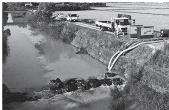
二級河川 猿渡川へポンプを設置し取水
