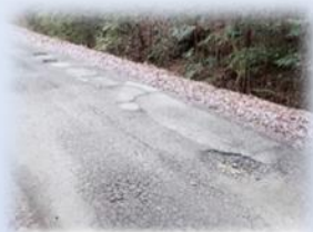
舗装の穴ぼこ・陥没
