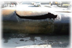
* 老朽化により破裂した水道管
