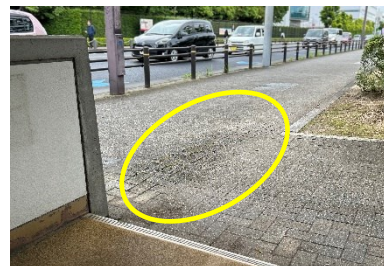
根上がり箇所
