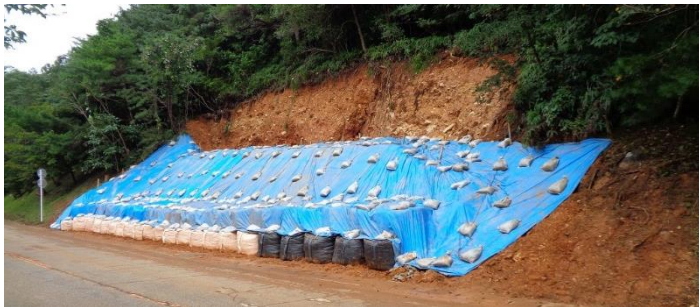
【法面が崩れた市道衣笠東七原線の状況（9月現在）】
